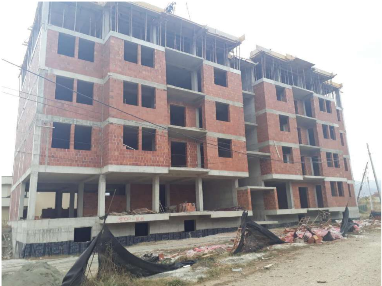
Lagja “Petrovë”, banimi kolektivë! Objekti në punim e sipër me kapacitet 30 banesa individuale !
